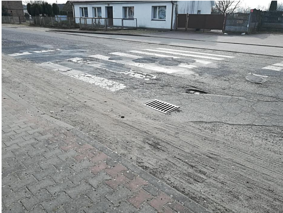
Fot. 5. Zdjęcie stanu istniejącego – widoczne ubytki nawierzchni jezdni
